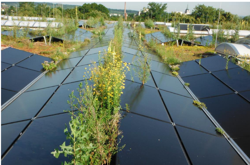
Abbildung 19 Nicht fachgerecht umgesetzte Ost-West-Anlage. Der nicht ausreichend gewählte Reihenabstand sorgt zudem für eine erschwerte Pflege. [51]
