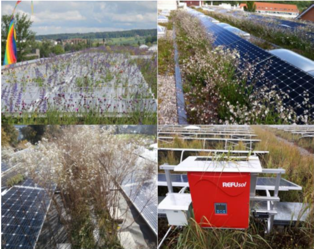
Abbildung 7 Beispiele für die Verschattung der Module durch die Vegetation bei unsachgemäßer Ausführung eines PV-Gründaches. [26,44,48]
