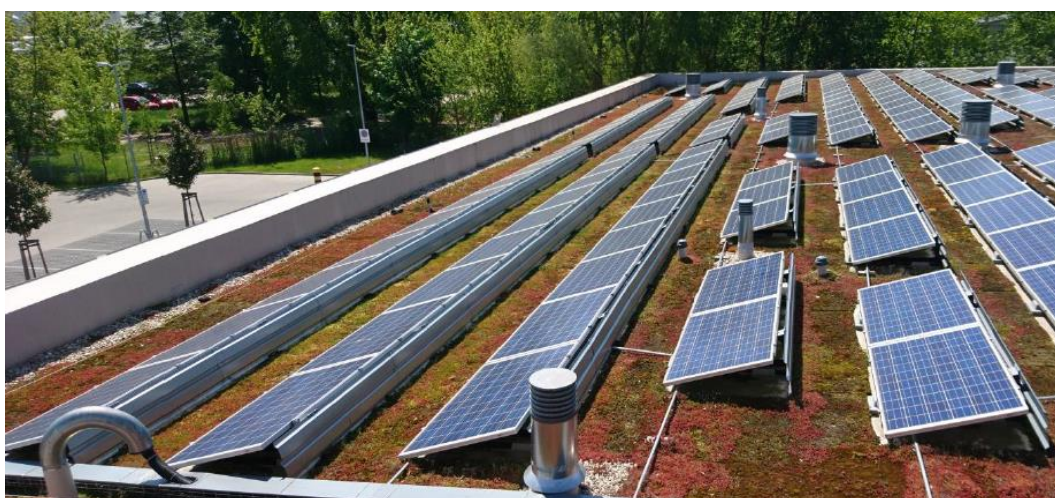
Abbildung 4 Beispiel eines PV-Gründaches, mit aerodynamischen Modulen und Leichtbegrünung. [26]
