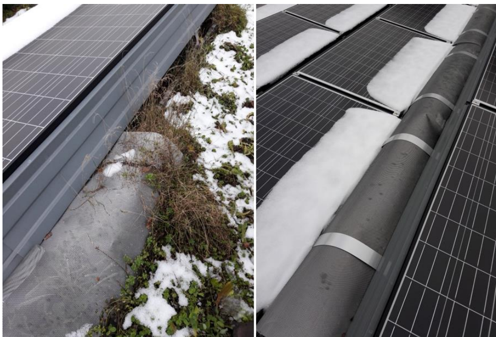
Abbildung 21 Installierte Gitternetze vor Modulen mit geringer Aufständerrhöhe zur Vermeidung von Verschattungsverlusten. [27]
